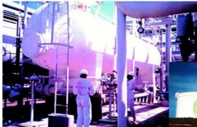
Cisteme di gas, Kuwait
